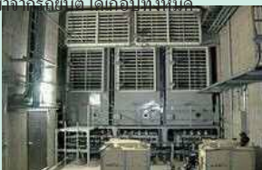
ระบบกำจัด NO 2
