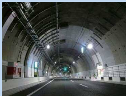
อุปกรณ์ป้องกันภัยภายในอุโมงค์
