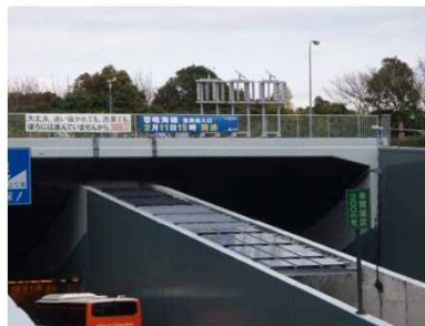
高速湾岸線 東京港TN坑口 太陽光発電
