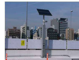
高速6号向島線 駒形PA 太陽光発電照明灯
