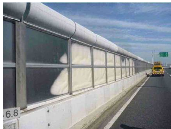
写真-5 透光板の一部焼損状況
