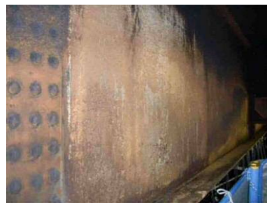
写真-2 G3主桁の一部変形状況
