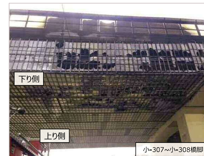
写真-2 足場の損傷状況
