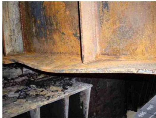
写真-1 G2主桁の一部変形状況
