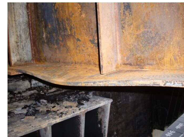
写真-2 主桁の一部変形状況
