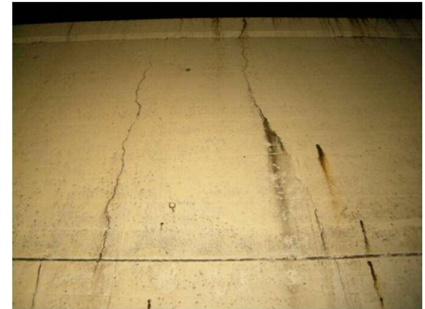
主筋方向のひびわれ (羽田トンネル坑口付近)
