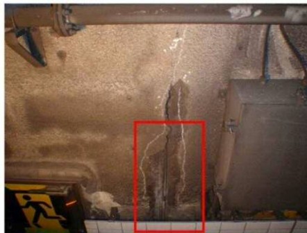
側壁部の主筋方向の鉄筋露出 (霞が関トンネル)
