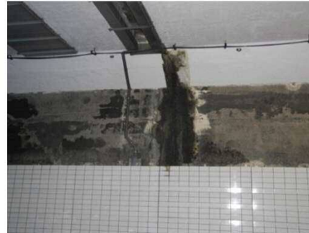
側壁部の漏水 (千代田トンネル)
