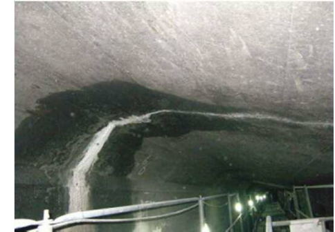
ダクト部側壁-頂版部 主筋方向のひび割れ (東京港トンネル)
