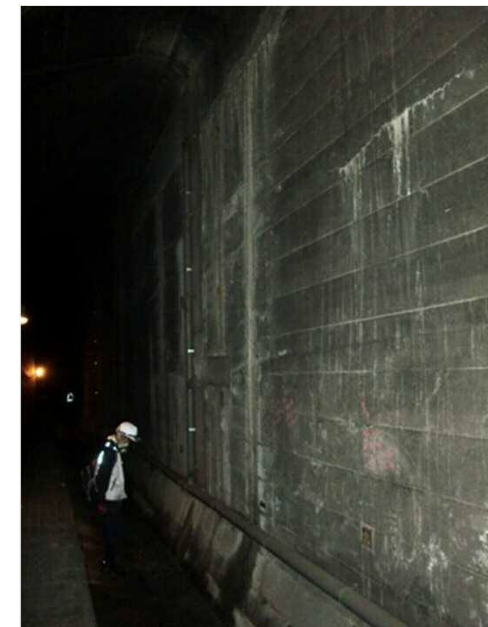
ダクト部側壁コンクリートの状況 (東京港トンネル)
