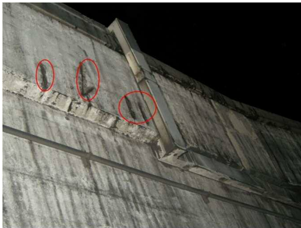
主筋方向の鉄筋露出 (霞が関トンネル坑口付近)
