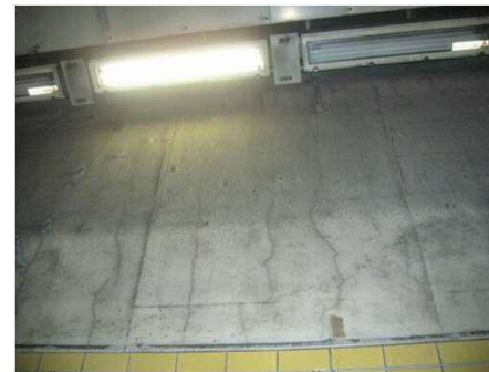
側壁の主筋方向のひび割れ (桜木町トンネル)
