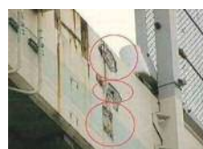
コンクリートの剥落
