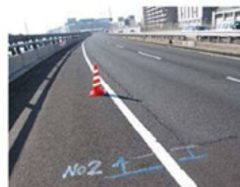
護岸埋立構造の路面ひび割れ
