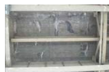
床板のひび割れ
