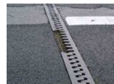
伸縮継手の損傷
