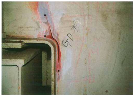
鋼桁切欠部のクラック
