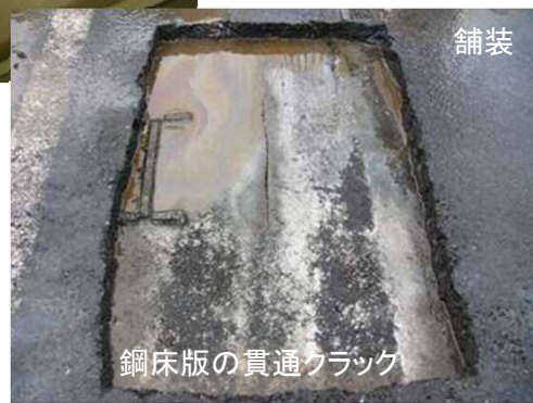
鋼床版クラック
