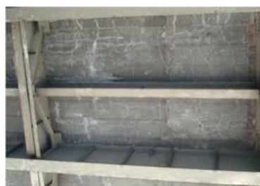
RC 床版の二方向ひび割れ
