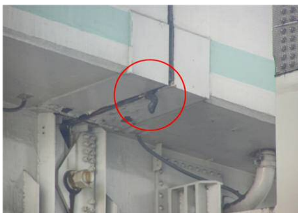
（神奈川 1 号横羽線 ：伸縮バックアップ材の落下恐れ）
