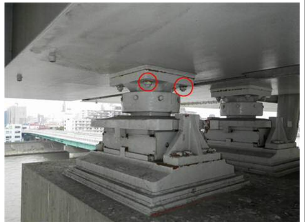
(中央環状線 船堀橋付近 : 支承セットボルトの緩み)
