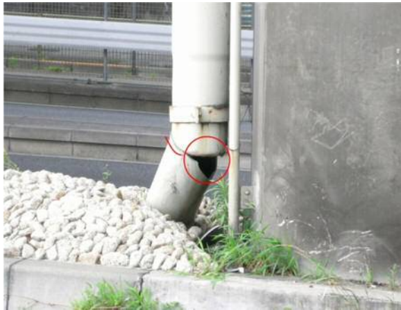
(5号池袋線 上池袋付近 : 排水管の割れ)
