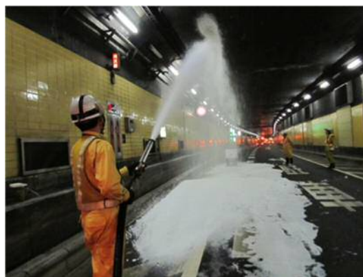
泡消火栓設備点検
