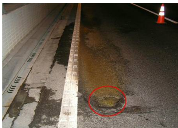
（湾岸線川崎航路トンネル付近 ：舗装穴）
