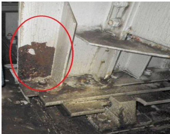
(3号渋谷線 駒沢付近 : 鋼桁端部腐食)
