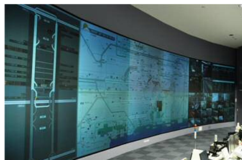
【首都高交通管制室】
