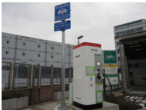
【電気自動車用急速充電器：平和島（上り）PA】
