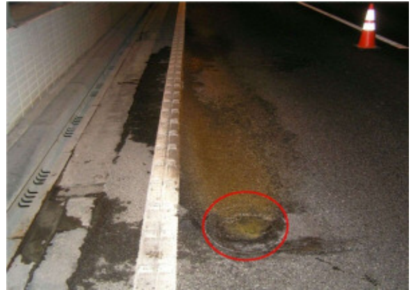
(高速湾岸線 川崎航路トンネル付近 : 舗装穴)
