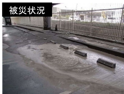
液状化による PA の被災状況
