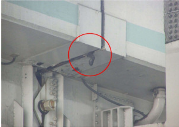
(高速神奈川 1 号横羽線 : 伸縮バックアップ材の落下恐れ)
