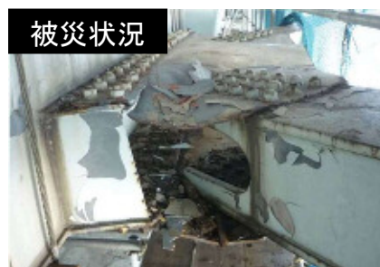
取付部材（横支材一下横構）の損傷
