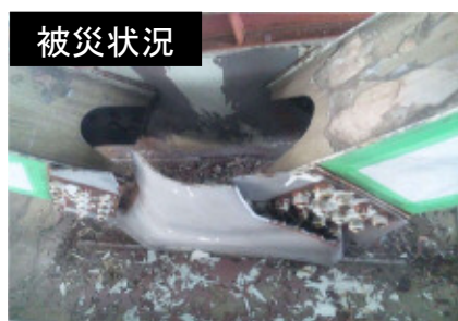
取付部材（横支材一対傾構）の損傷
