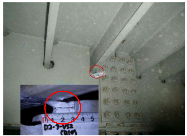
(6 号向島線 向島付近 : 床版とリブの溶接部のき裂)
