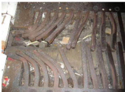
ジョイントの損傷
