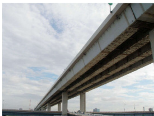
(施工前) 鋼桁・橋脚の錆
