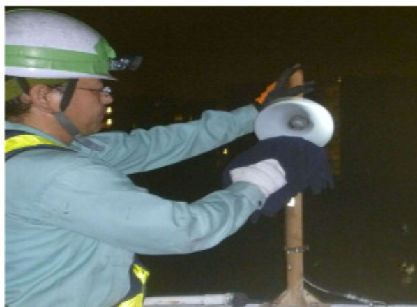
【車両感知器点検 （高速1号横羽線 東神奈川入口付近） 平成23年9月実施】
