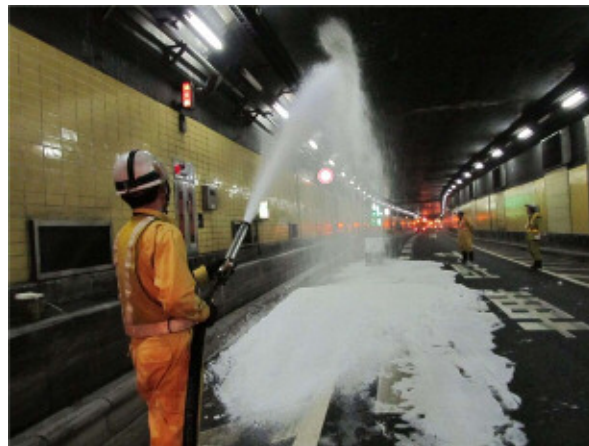
【泡消火栓設備点検 （高速八重洲線 八重洲トンネル） 平成23年7月実施】
