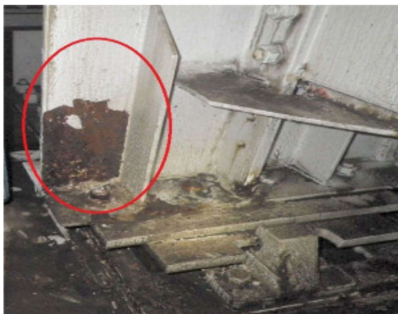
(3 号渋谷線 駒沢付近 : 鋼桁端部腐食)
