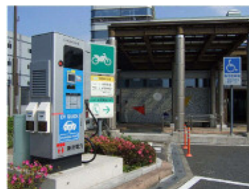
【平和島（上り）パーキングエリアに設置した電気自動車用急速充電器】
