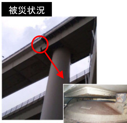
橋桁を支持する支承が脱落
