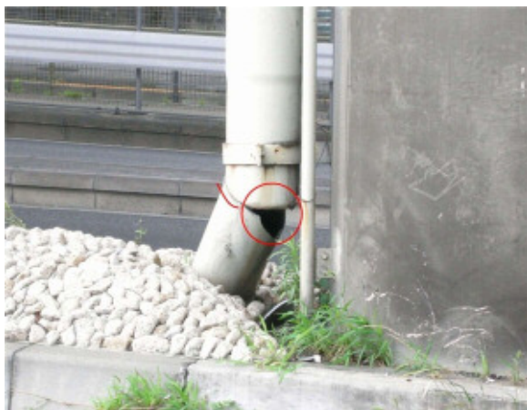
(5 号池袋線 上池袋付近 : 排水管の割れ)
