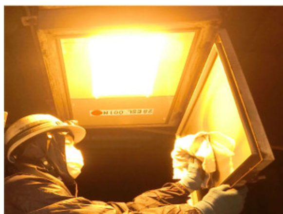
【トンネル内照明点検 （湾岸線 多摩川トンネル） 平成23年5月実施】
