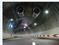
トンネル照明のLED化
