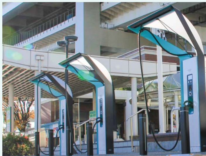
6台同時充電可能な新型EV用急速充電器 (大黒PA)
