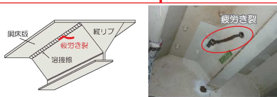
損傷状況(鋼床版の疲労き裂)
