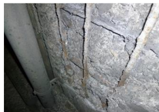
側壁部の鉄筋露出
