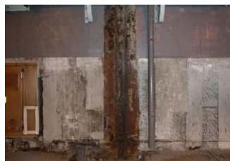
継手部の腐食
