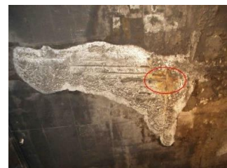
コンクリート剥落、鉄筋露出
