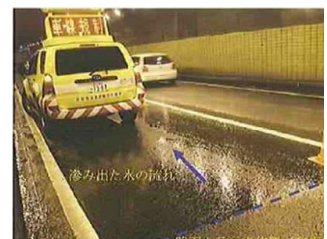
底版からの漏水
