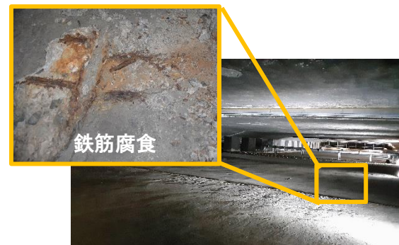
羽田トンネル内の損傷状況(ダクト内)
