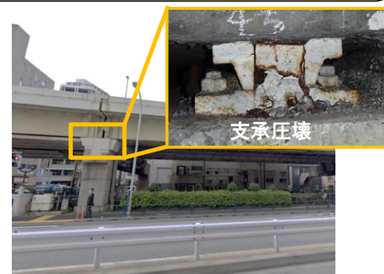
橋梁狹隘部の損傷状況(支承部)
