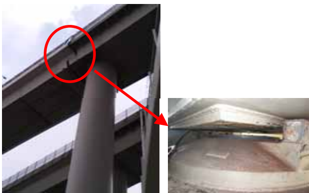
橋桁を支持する支承が脱落
