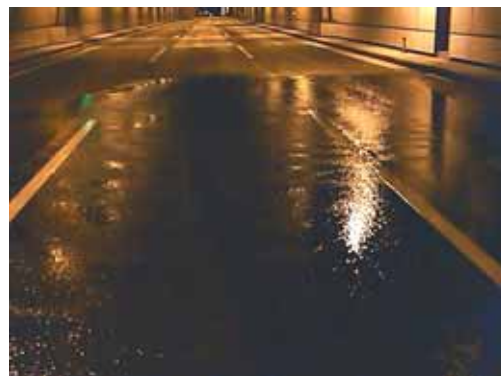
トンネル継目からの漏水
