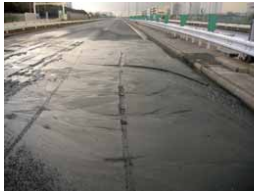
路面損傷(液状化)
