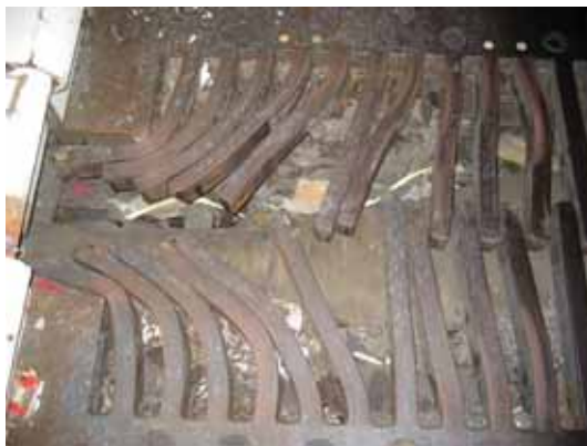
伸縮継手の損傷
