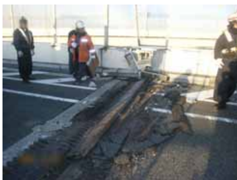
路面損傷状況
