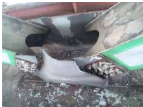
取付部材(横支材 - 対傾構)の損傷
