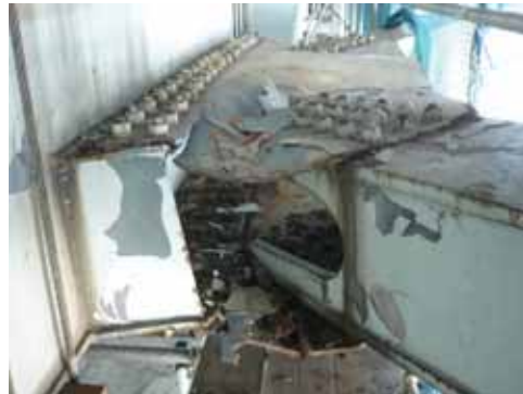
取付部材(横支材 - 下横構)の損傷
