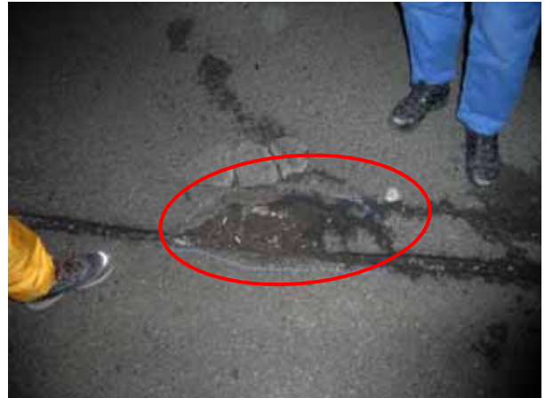
(都心環状線芝公園入口 ：舗装の損傷)
