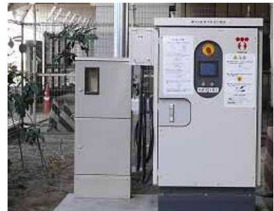
【市川PAに設置した電気自動車用急速充電器】
