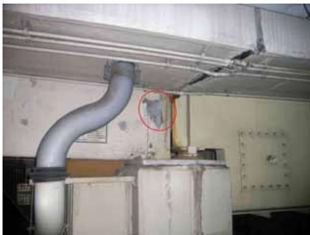
(2号目黒線天現寺付近 ：剥離・PC 鋼棒露出)
