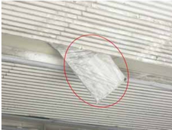
(1号羽田線海岸二丁目付近 ：裏面吸音材の落下恐れ)
