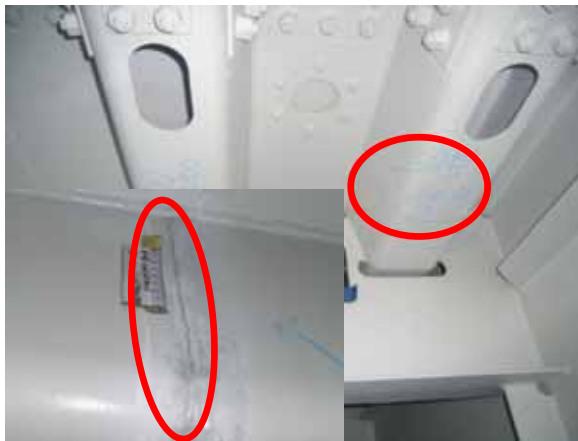
(中央環状線滝野川入口付近 ：鋼床版Uリブの突合せ溶接部の亀裂)
