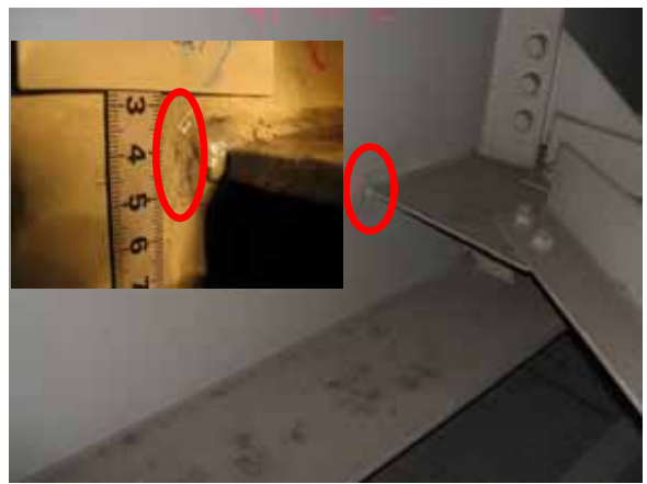
(中央環状線掘切付近：鋼I桁と ガセットプレートの溶接部の亀裂)
