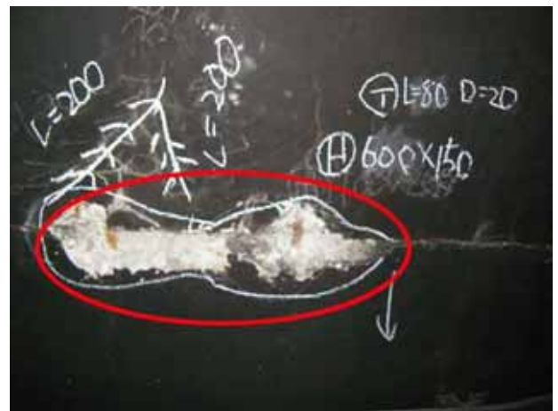
(八重洲線八重洲トンネル内 ：天井部鉄筋露出)
