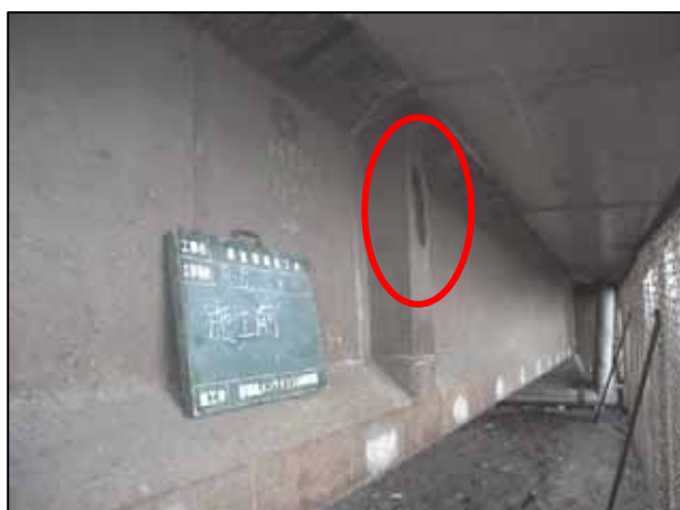
(施工前) PC橋横締め部クラック
