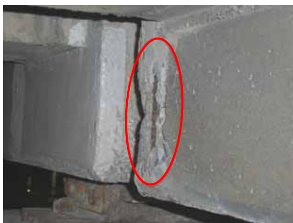
( 6 号向島線箱崎付近 ：コンクリート桁鉄筋露出 )
