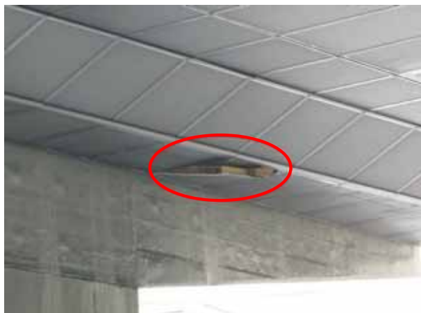
( 4 号新宿線笹塚付近 ：裏面吸音板の損傷 )
