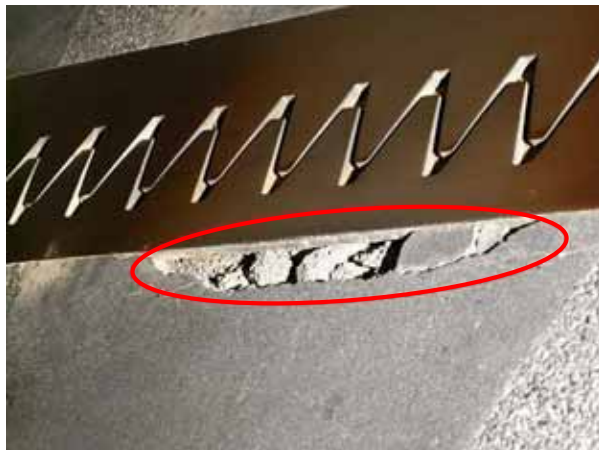
( 5 号池袋線飯田橋付近 ：舗装の損傷 )
