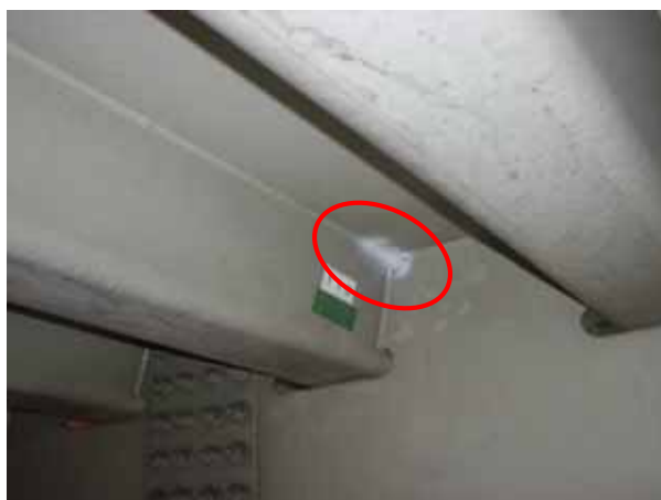
( 中央環状線四つ木付近 ：鋼床版 U リブの突合せ溶接部の亀裂 )
