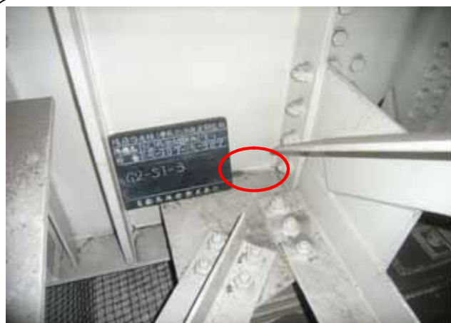
( 3 号渋谷線三軒茶屋付近 ：鋼 I 桁とガセットの溶接部の亀裂 )
