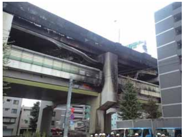
【火災鎮火直後の状況】
