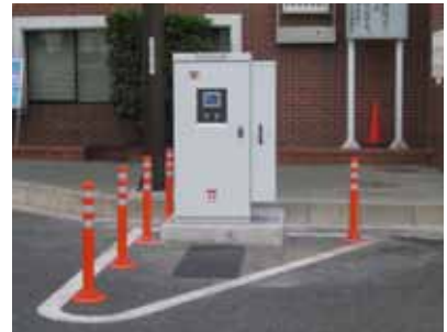
【大黒パーキングエリアに設置した電気自動車用急速充電器】
