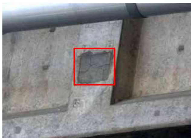
( 4 号新宿線上高井戸付近 ：PC 定着部の亀甲状クラック )
