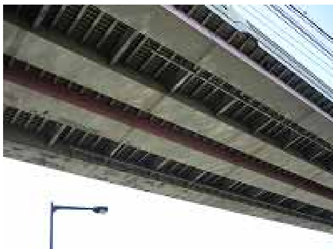
【塗装の劣化の事例】
