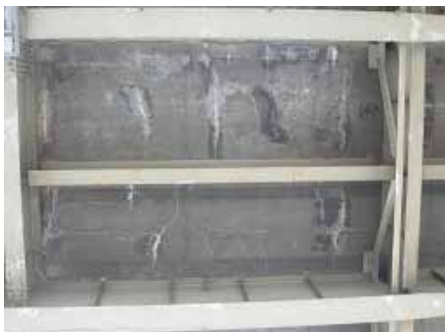
【コンクリート構造物のひび割れ事例】
