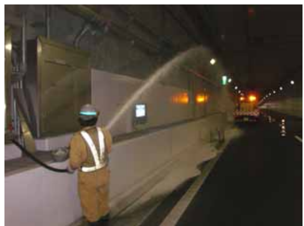
【泡消火器設備点検 (埼玉新都心線新都心トンネル) 平成 19 年 11 月実施】
