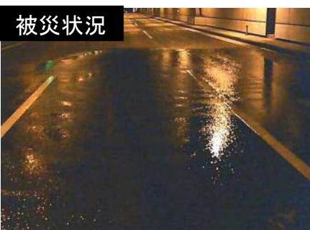
トンネル継目からの漏水
