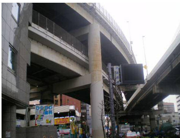
(施工前) 鋼桁・橋脚の錆
