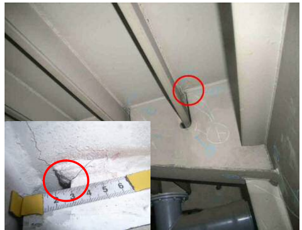
(4号新宿線初台付近：床版と 横リブの溶接部のき裂)
