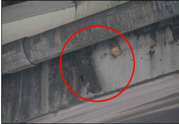
(3号渋谷線池尻付近 ：配水管の落下恐れ)
