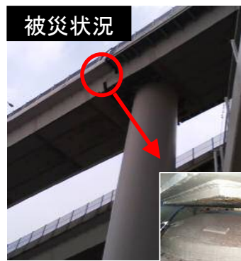
橋桁を支持する支承が脱落
