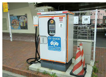
【八潮パーキングエリアに設置した電気自動車用急速充電器】
