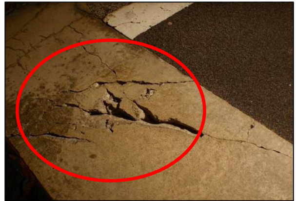
(6号向島線向島付近 ：ジョイント後打ちコンクリートの損傷)
