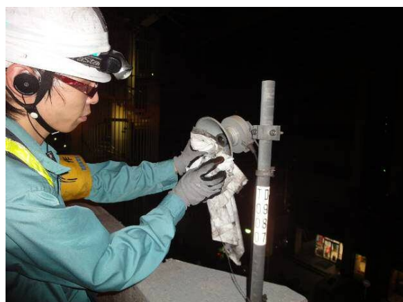
【車両感知器点検 （高速 9 号深川線木場付近） 平成 22 年 5 月実施】
