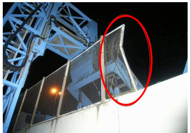
(6号向島線 両国付近 ：フェンスの損傷)
