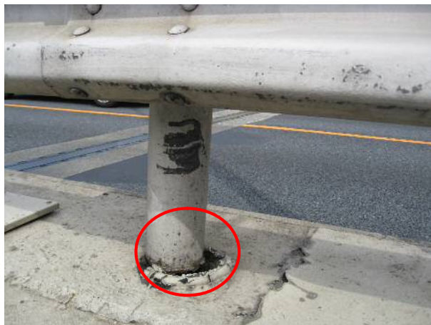
(4号新宿線永福付近 ：ガードレール基部の損傷)
