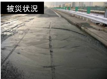
路面損傷（液状化）
