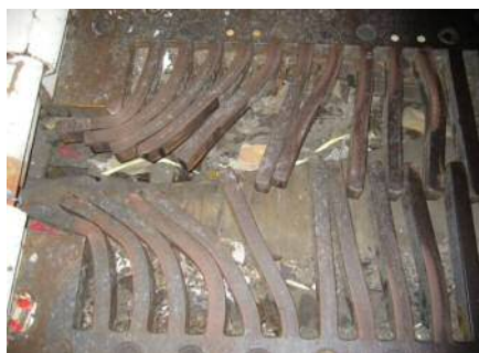
ジョイントの損傷
