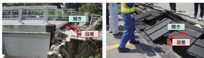
橋梁損傷事例
