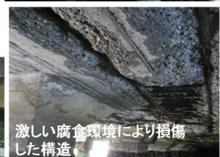
激しい腐食環境により 損傷した構造
