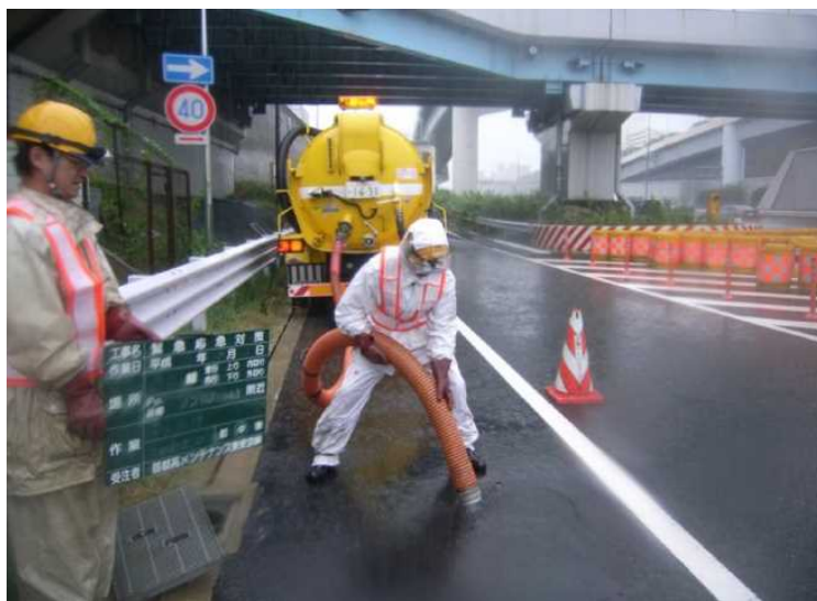
路面滞水処理状況
