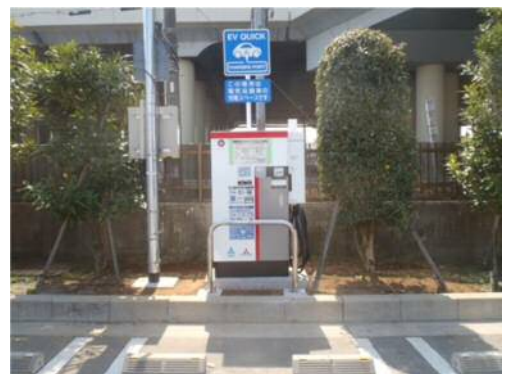
電気自動車用急速充電器：川口 PA
