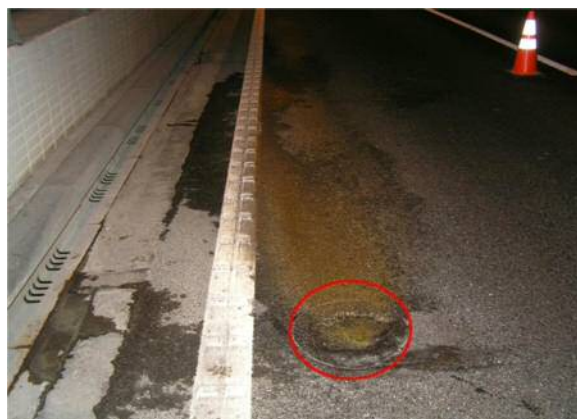
(湾岸線川崎航路トンネル付近 : 舗装穴)
