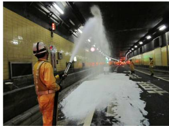
泡消火栓設備点検
