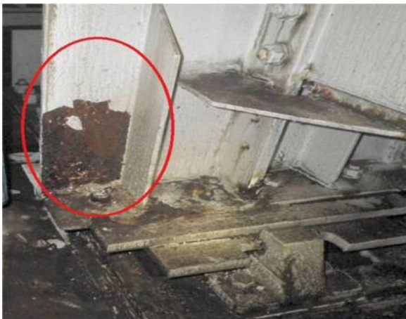
(3号渋谷線 駒沢付近 : 鋼桁端部腐食)
