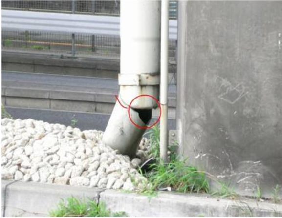
(5号池袋線 上池袋付近 : 排水管の割れ)
