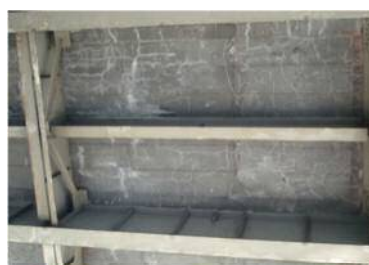
RC 床版の二方向ひび割れ
