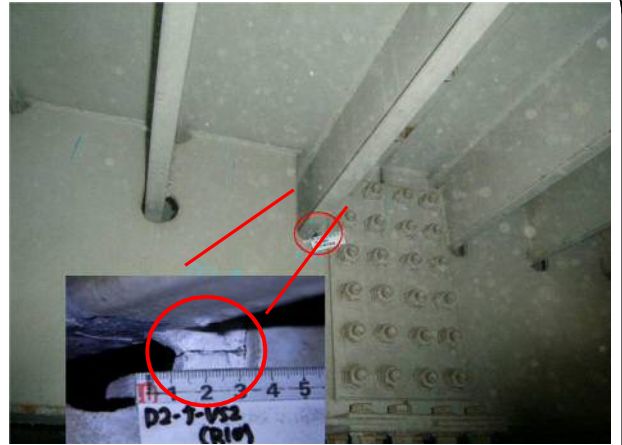
(6号向島線 向島付近 : 床版とリブの溶接部のき裂)
