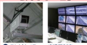
② テレビカメラ 交通管制室
