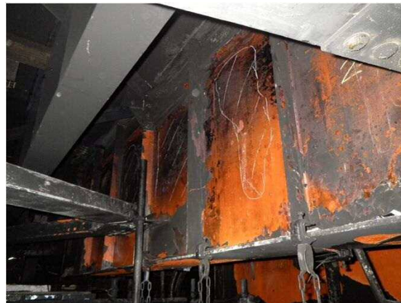
写真-7 G5桁ウェブ一部変形
