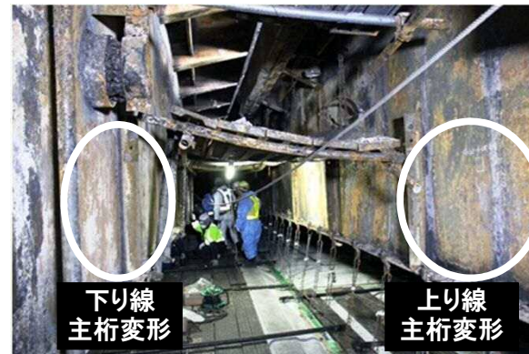
写真-1 上り線及び下り線主桁変形
