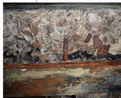
写-②: 鉄筋とコンクリートの付着状況
