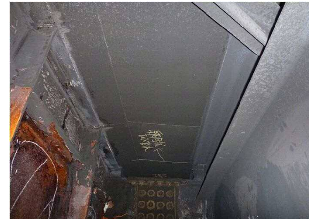
写真-9 下り線 RC床版にすず付着
