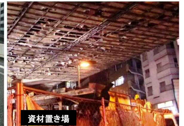
写真-6 資材置き場直上 仮設足場損傷
