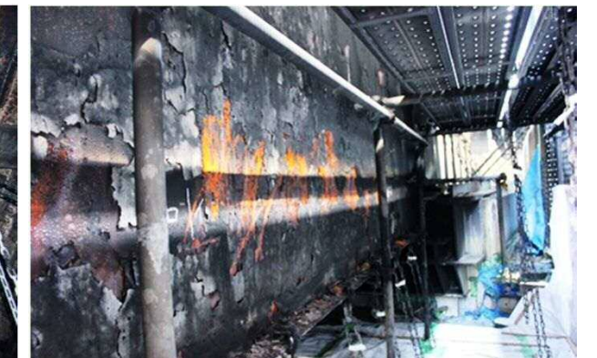
写真-4 下り線主桁塗装剥がれ(変形無し)
