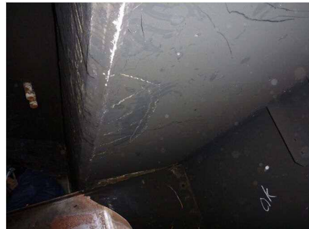
写真-8 上り線 高欄のすず付着
