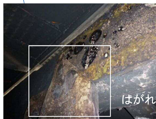
写-③: 剥落防止シートのはがれ
