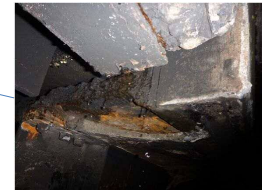
写-⑤:すす付着及びコンクリートかぶりの剥落
