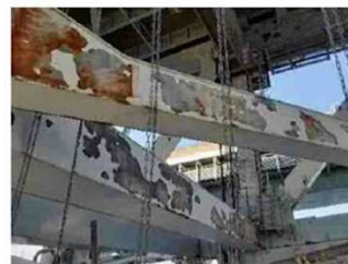
塗膜のはく離・腐食
