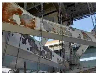
塗膜のはく離・腐食
