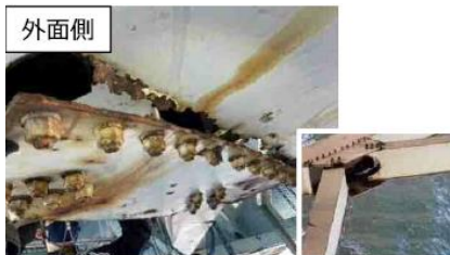
外面側 ガセットプレートの腐食・破断 ※破断箇所は応急補修済
