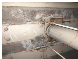
鋼板の腐食 目黒線(2019.12)
