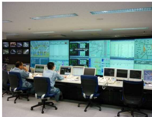
施設管制室での監視
