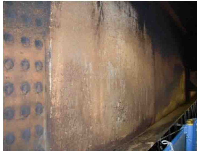
写真-11 G3主桁（下り線）ウェブ変形状況
