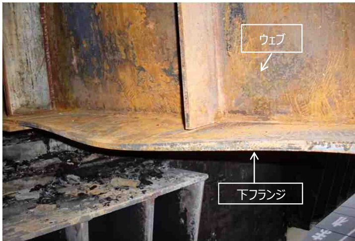
写真-10 G2主桁（下り線）下フランジ変形状況
