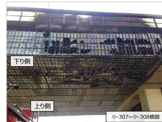
写真-2 足場の損傷状況
