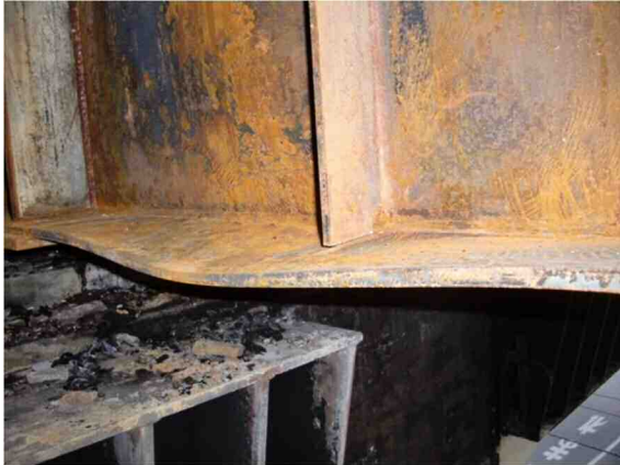
写真-1 G2主桁の一部変形状況
