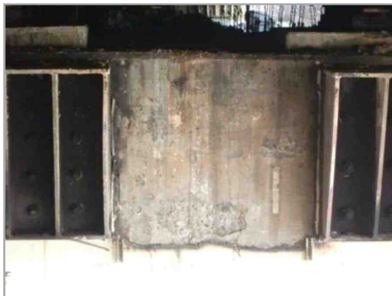
写真-3 コンクリート橋脚の一部変色、剥離
