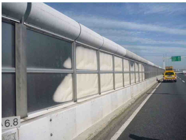
写真-5 透光板の一部焼損状況
