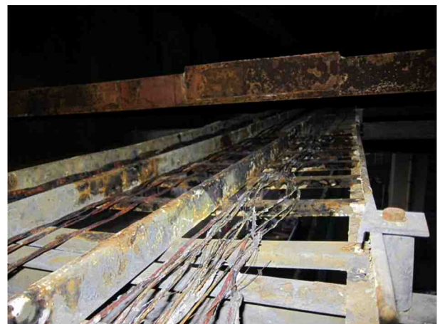
写真-6 附属物(ケーブルラック)焼損状況
