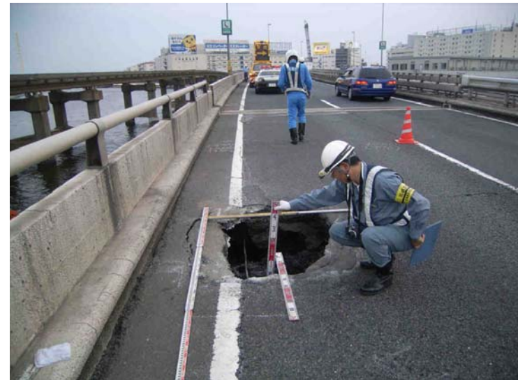
路面の陥没(平成20年6月発生)
