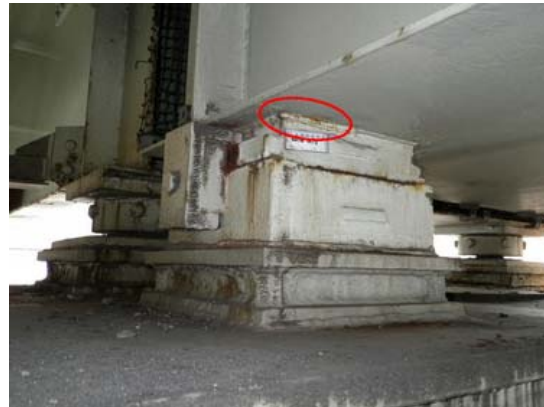
【支承部の疲労き裂】
