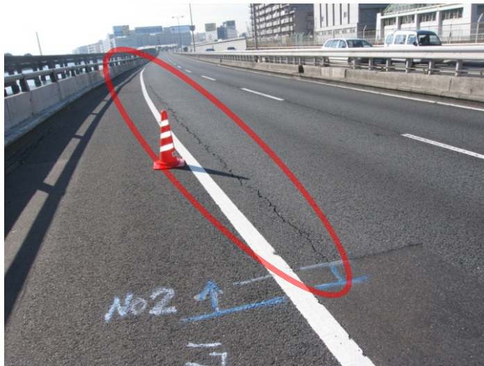
路面のひび割れ(平成18年12月発生)
