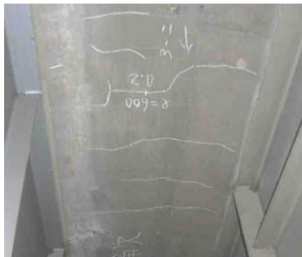
1方向ひび割れ
