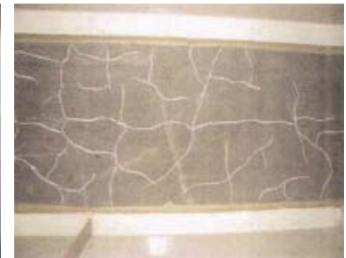
亀甲状ひび割れ
