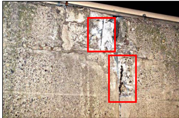
コンクリート剥離・鉄筋腐食
