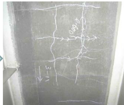
2方向ひび割れ
