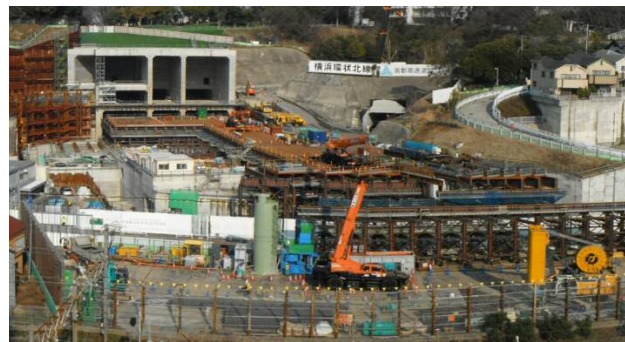
写真③ 生麦JCT (鉄道交差部) (高架橋架設のための構台工を実施中)
