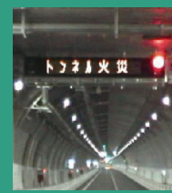
トンネル警報板
