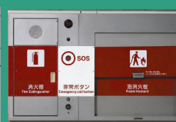
⑦消火器・泡消火栓・ 押ボタン式通報装置
