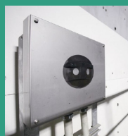
③火災検知器
