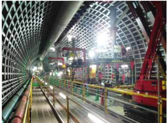
中央環状新宿線施工状況(神山・代々木シールドトンネル内)
