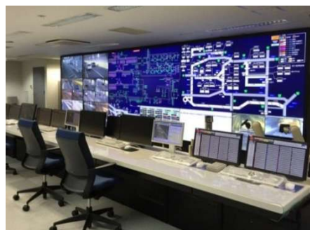
施設管制システム
