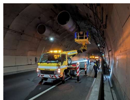
トンネル換気設備点検
