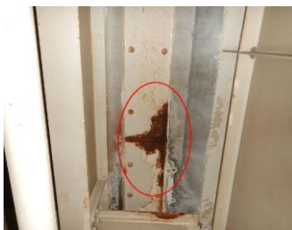
補強鋼板の腐食 渋谷線(2019.9.30)
