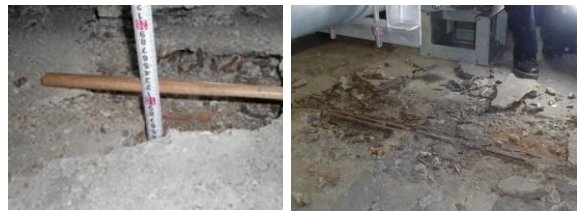
中床版上面のはく離・断面欠損・鉄筋腐食
