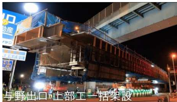
与野出口上部工一括架設 与野出口一括架設工のタイムラプス動画
