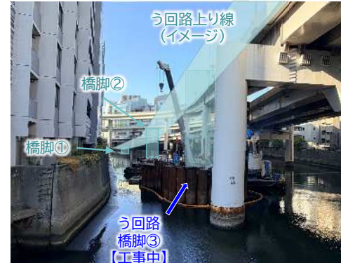
写真③ う回路設置工事状況 (日本橋川内 う回路橋脚基礎鋼管杭圧入)
