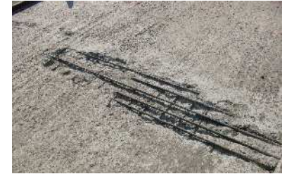
老朽化した床版
