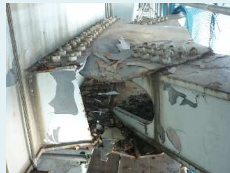
取付部材の損傷
