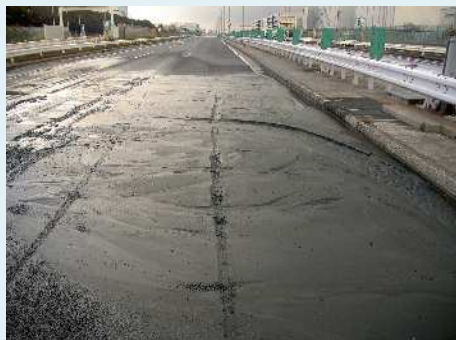
液状化による 路面損傷
