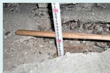
中床版上面のコンクリート剥離
