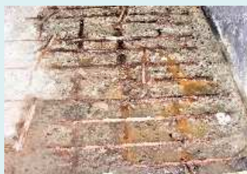
腐食、消失した鉄筋
