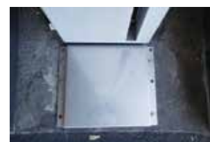
融雪マット設置状況
