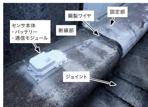
高速上に設置した段差検知センサ
