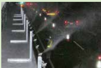
トンネル内ミスト噴霧設備
