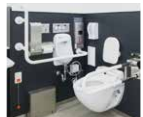
辰巳第二PAにおける設置例
