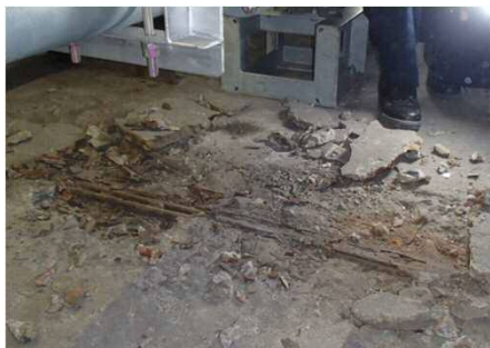
中床版上面の鉄筋一部消失
