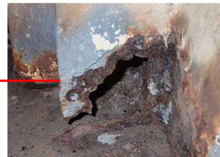
鋼桁の腐食（近景写真）
