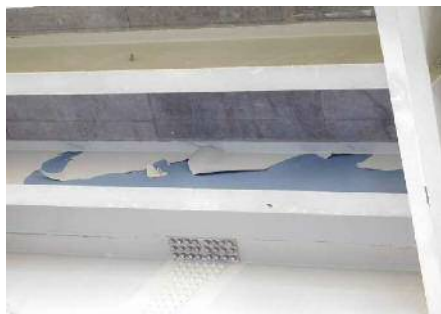
塗膜が下地よりはく離
