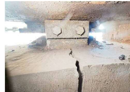
支承下部の破損
