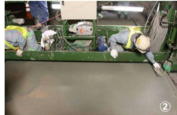
② 打設工（上面増厚工） [ ファイニッシャーによる上面補強材の敷き均し ]
