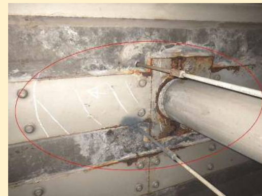
鋼板の腐食 目黒線(2019.12)
