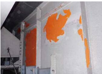
塗膜が下地よりはく離
