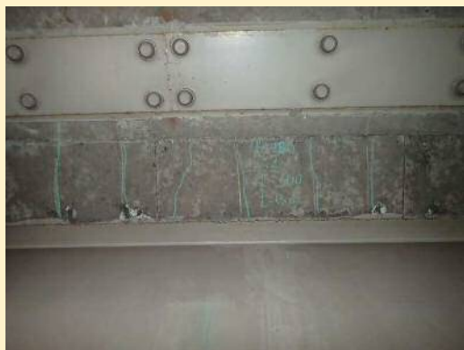
コンクリートひび割れ 横羽線(2022.4)
