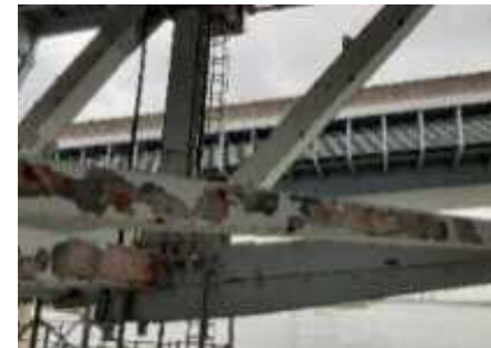
塗膜のはく離・腐食
