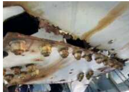
ガセットプレートの腐食・破断
