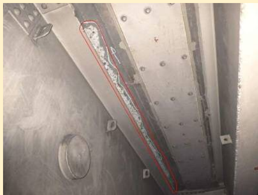
コンクリートはく離 目黒線(2019.12)
