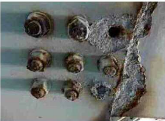
高力ボルトF11Tの腐食・破断
