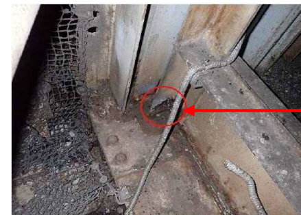
鋼桁の腐食（遠景写真）
