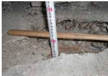
中床版上面のコンクリートはく離
