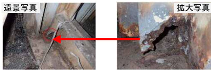
塗膜劣化に起因した鋼材腐食(2022.1)
