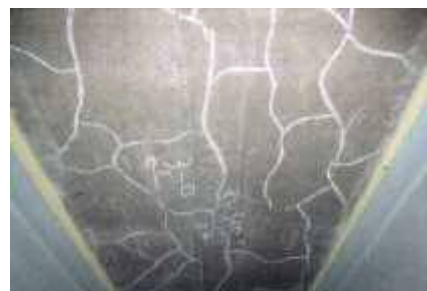
コンクリート床版の亀甲状ひび割れ
