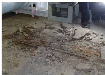
中床版上面の鉄筋一部消失
