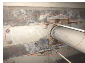
鋼板の腐食 目黒線(2019.12)
