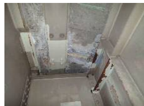
コンクリートひび割れ・漏水・遊離石灰 横羽線(2022.4)
