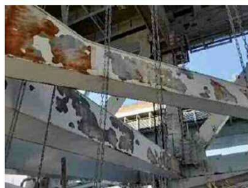
塗膜のはく離・腐食
