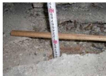
中床版上面のコンクリートはく離
