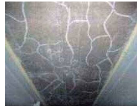
床版損傷状況
