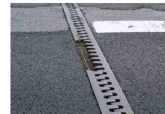
伸縮継手の損傷
