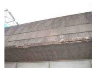
高欄水切り部の剥落
