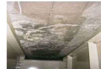
床板のひび割れ
