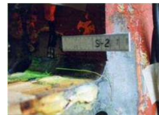
鋼製橋脚の疲労き裂
