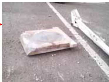
脱落した支承の一部
