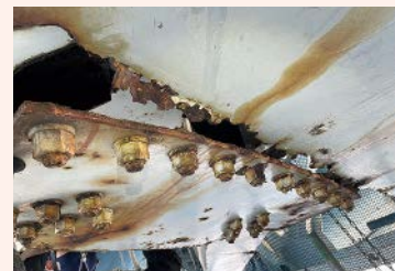
ガセットプレートの破断(2021年)
