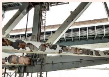
塗膜はく離による腐食(2021年)
