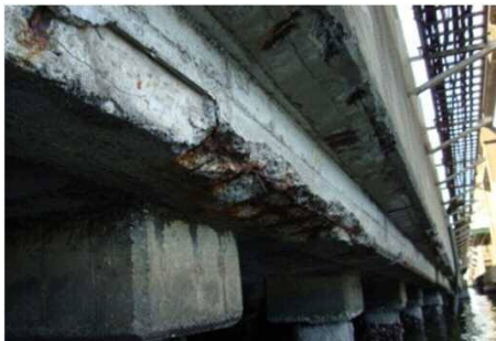
激しい腐食環境により損傷した構造
