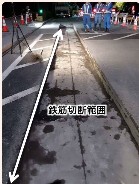
損傷発生時の状況（11/8）
