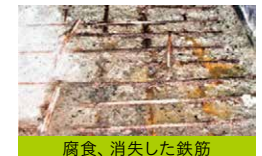
腐食、消失した鉄筋
